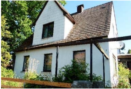
Baufälliges Haus Rebberlaher Straße 5
