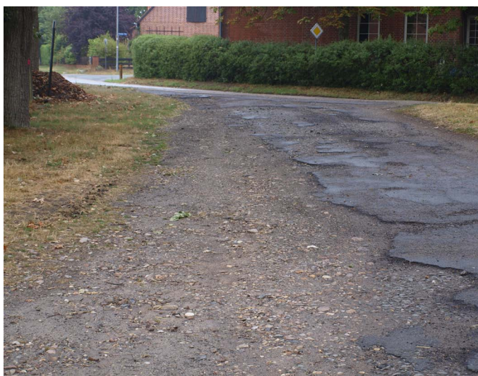
Abb. 29: Straße mit Sanierungsbedarf in Spechtshorn Quelle: Eigene Abbildung
